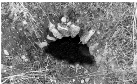
Εικ. 10. Ο κατεστραμμένος υπόγειος υδραγωγός.
